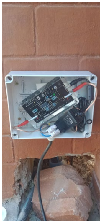
Vulcan 5000 instalado dentro de una caja protectora
