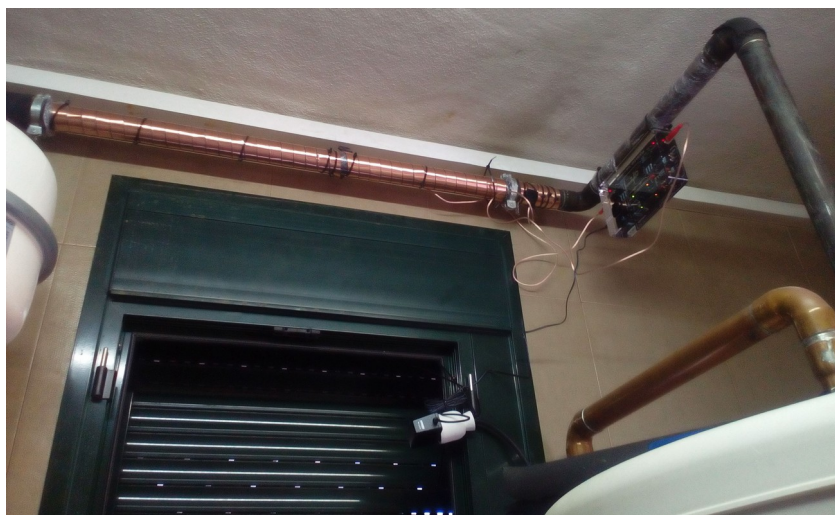
Vulcan S10 安装在热水循环管
