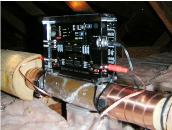
Vulcan S10 安装在 Bodega海边住宅宿舍主水管
