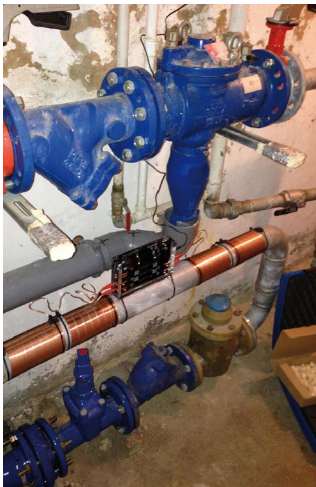
El Vulcan S25 instalado en la fábrica de aluminio Alcoa en Francia
