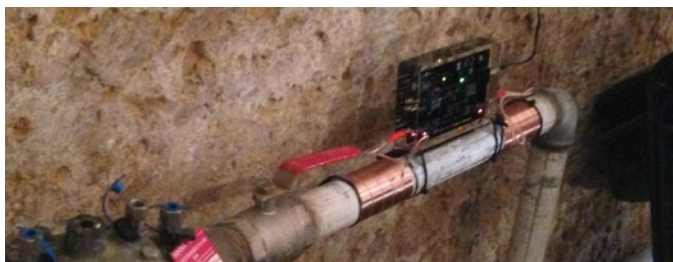
El Vulcan S10 instalado en la fábrica de aluminio Alcoa en Francia
