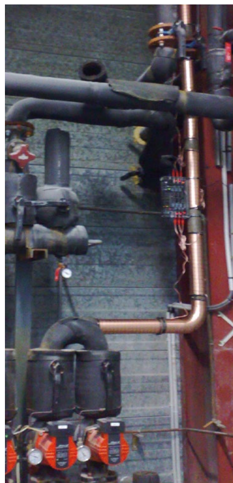
Vulcan S100 instalado en Avignon Ceramic
