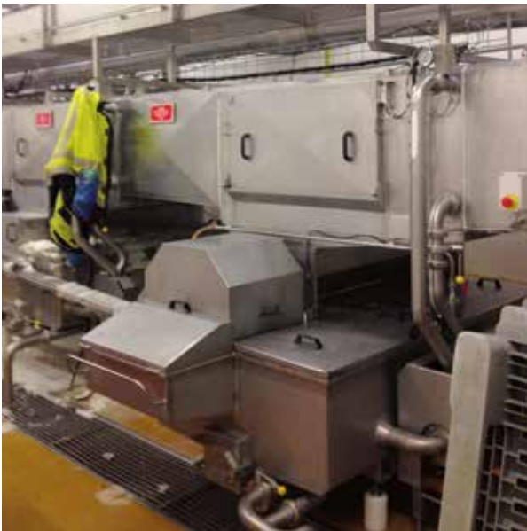
Lavadora utilizada para los contenedores blancos
