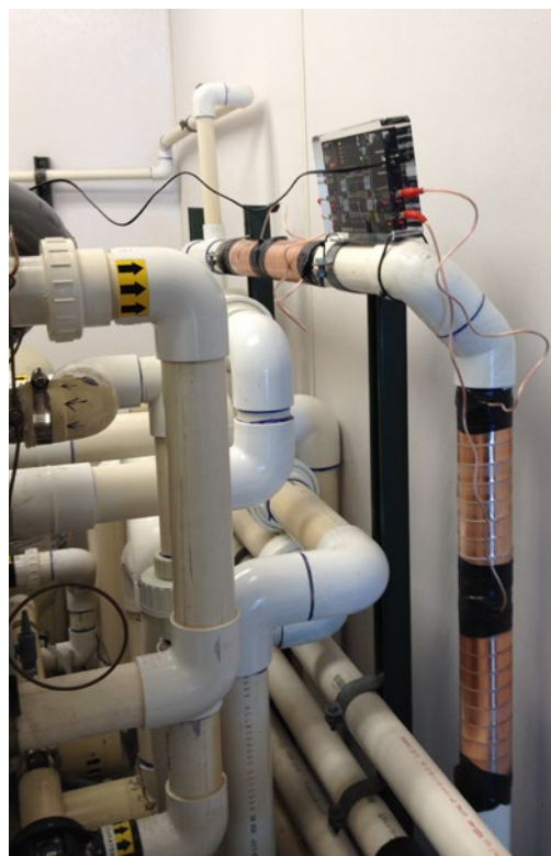
Vulcan S25 instalado para el tratamiento del agua del Spa
