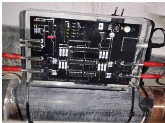
Vulcan S25 fue instalado en la tubería principal de agua para 132 apartamentos
