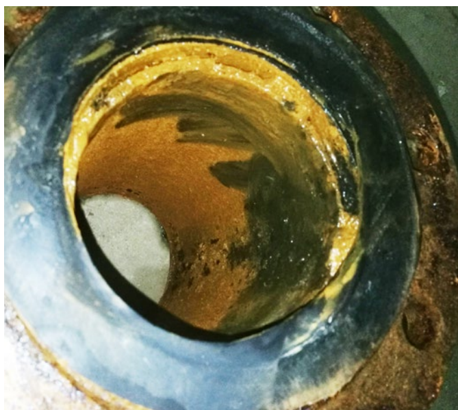
La cal se puede limpiar fácilmente, y la tubería cuenta con una superficie lisa
