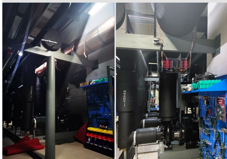
Vulcan S500 en el edificio B
